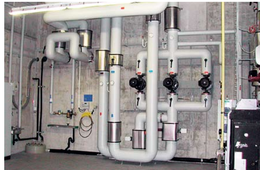
Der Wärmestrom fliesst im Umkreis von 300 Metern in 17 Gebäude.
